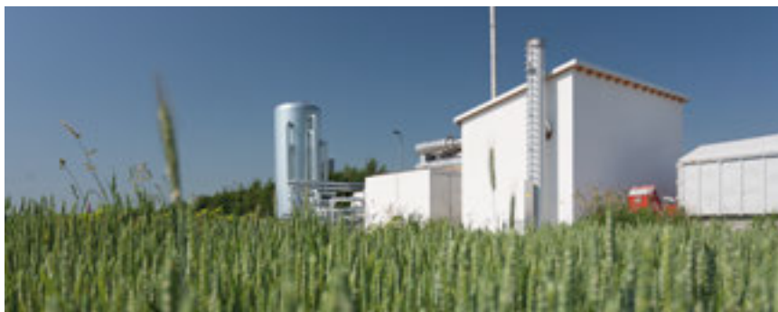
Die Kraft-Wärme-Anlage der Grüne Werte Energie GmbH in Eitting (Nähe Flughafen München) stellt grünen Strom, Wärme und Kälte aus nachhaltigen Rohstoffen aus der unmittelbaren Umgebung her.
